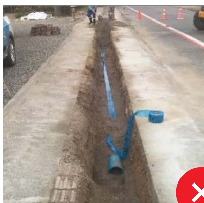
Fita de sinalização e proteção da rede de água colocada de maneira inadequada, logo acima da tubulação, pois quando houver escavação, a rede será danificada.
