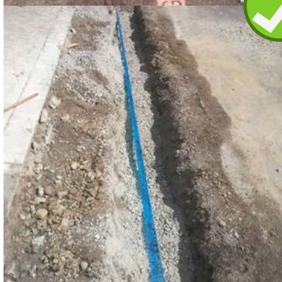
Fita de sinalização e proteção da rede de água
