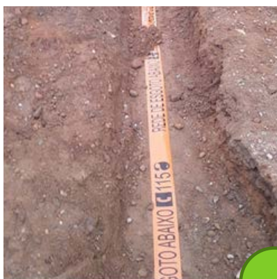
Fita de sinalização e proteção da rede coletora de esgoto
