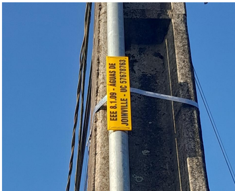
Figura 42 – Plaqueta de identificação da unidade consumidora (padrão de entrada subterrâneo).
