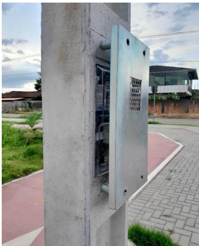
Figura 44 – Proteção instalada no poste.
