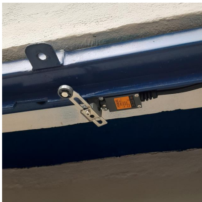
Figura 5 – Interruptor abertura de porta (fim de curso) do abrigo.
